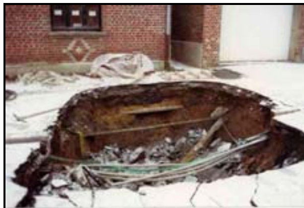
Photographie 2.1: Effondrement sous trottoir, impact sur l'utilisateur et les réseaux alentours (réseaux de communication, gaz, eau potable...)
