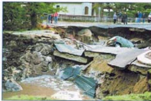
Photographie 2.3 : Effondrement d'un tronçon dû d'une part à l'infiltration, amenant les fines dans la conduite, puis création de vides autour de l'ouvrage, Pessac (Bordeaux, Quotidien Sud-Ouest), Novembre 2001
