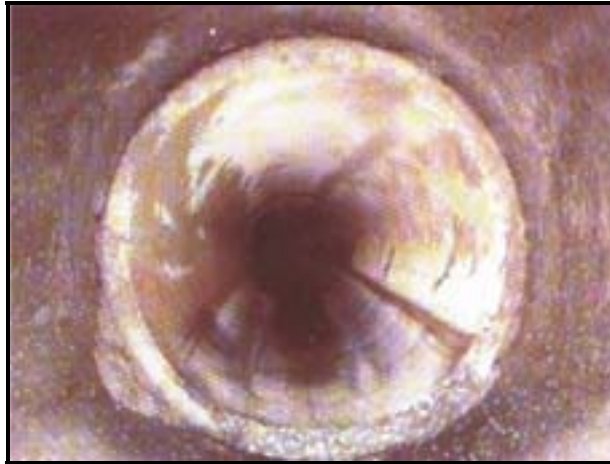
Photographie 3.9: Exemple d'un emboîtement insuffisant suite à une flache (extrait du glossaire AGHTM, édition 1998)
