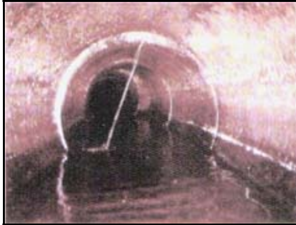
Photographie 2.5: Dysfonctionnement avéré d'infiltration d'eaux parasites dans la conduite: impact indirect de surconsommation d'énergie lors du traitement de l'effluent au niveau de la STEP.
