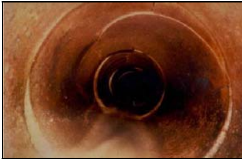
Photographie 2.6 : Photographie d'une fissure ouverte hélicoïdale (extraite de la norme 13508-2).
