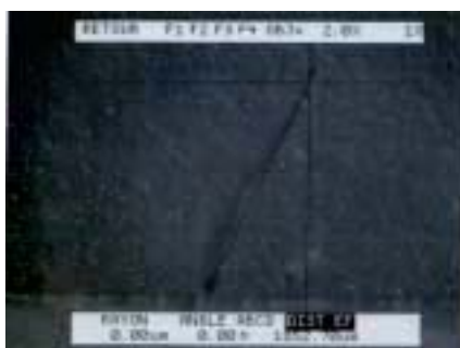
Figure 48 : Mesure de la profondeur de fissuration
