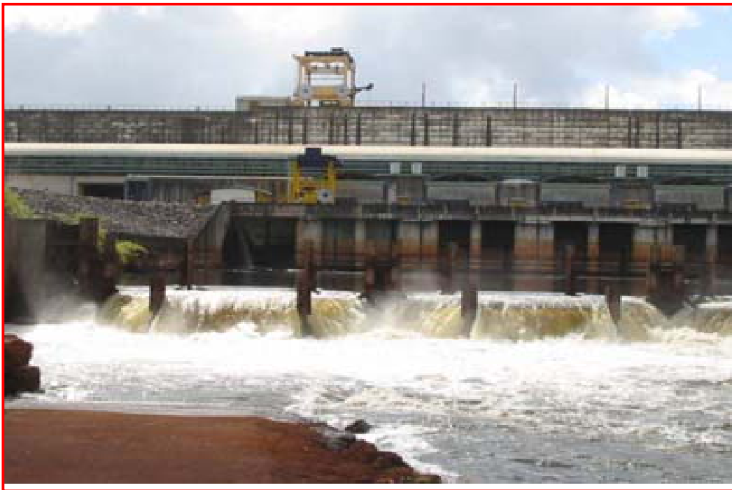
Figure 38 : Barre d'oxygénateurs à l'aval du barrage de Petit-Saut (photo Y. Dominique).
