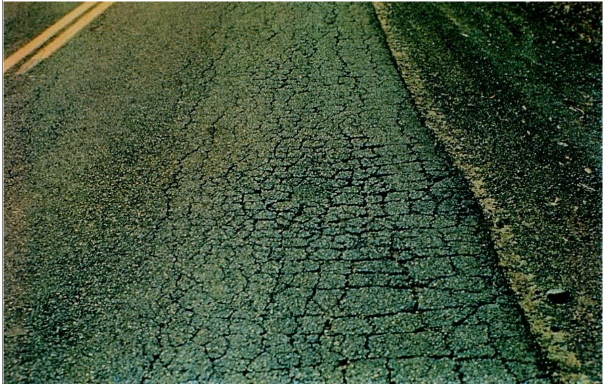
Figure 1.4 : fissuration par fatigue d'une chaussée (d'après http://hotmix.ce.washington.edu )
