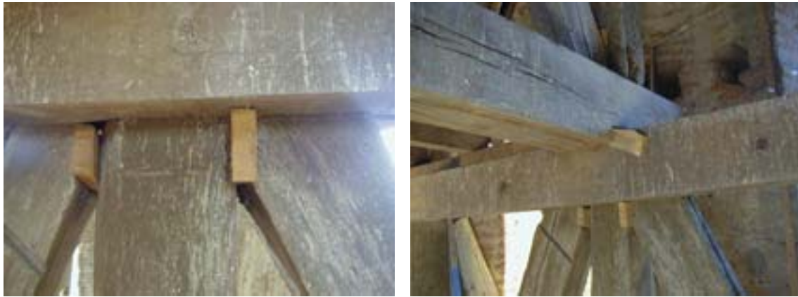
figure 14 : Vues d'un assemblage dont les jeux sont empêchés par des cales en bois.
