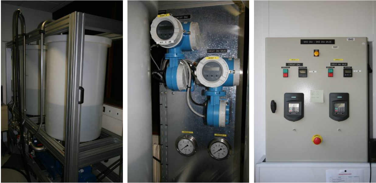
Fig. 42. Photographies du banc hydraulique : cuve, débitmètre, armoire de commande
