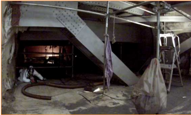
Difficulté d'accès obligeant l'opérateur à se coucher au sol
